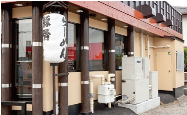
店舗脇に設置されたジェネライト<一番舎 日進店>
